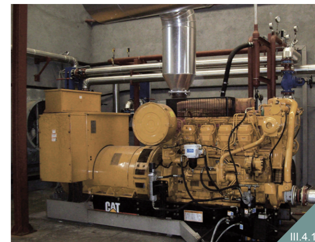
Instalación de coxeración
