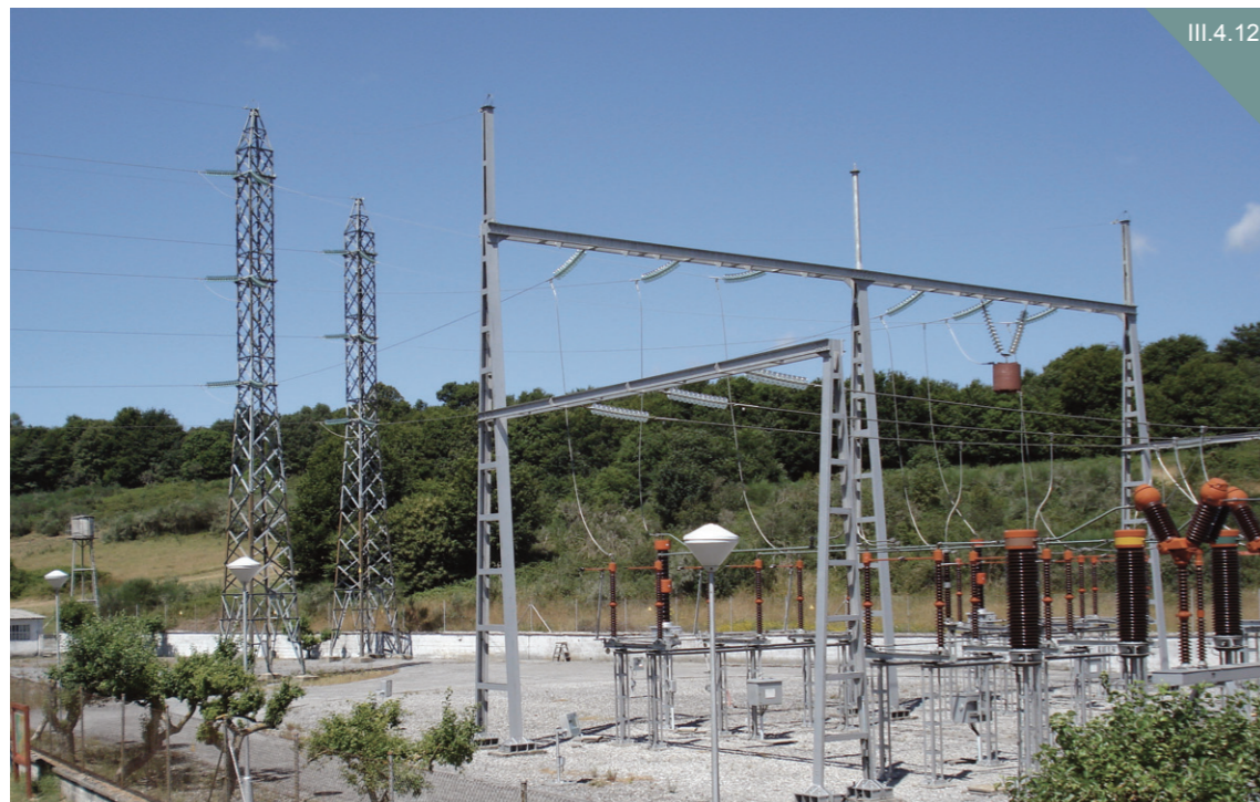
Subestación de distribución
